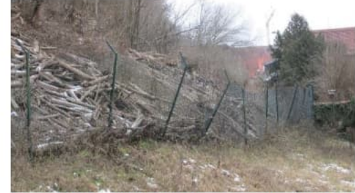
Zerstörter Sicherheitszaun oberhalb PI
